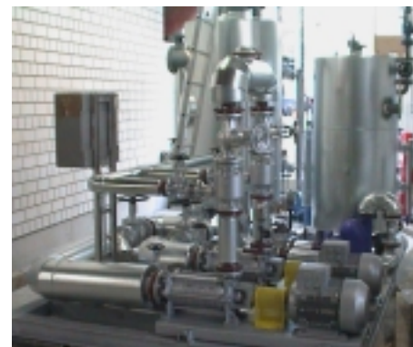
Entspanner fertig montiert beim Kunden
